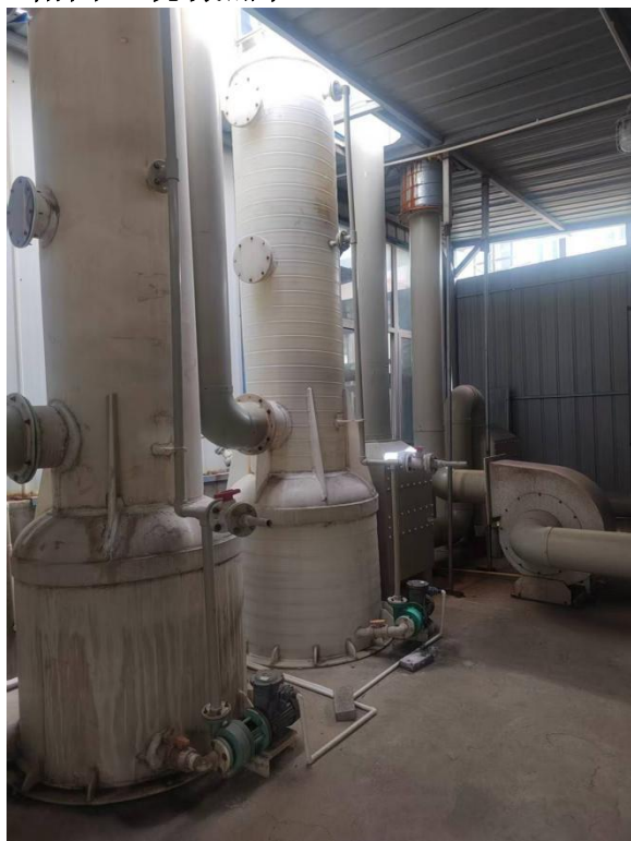
“水喷淋+ 除湿+二级活性炭吸附”装置
