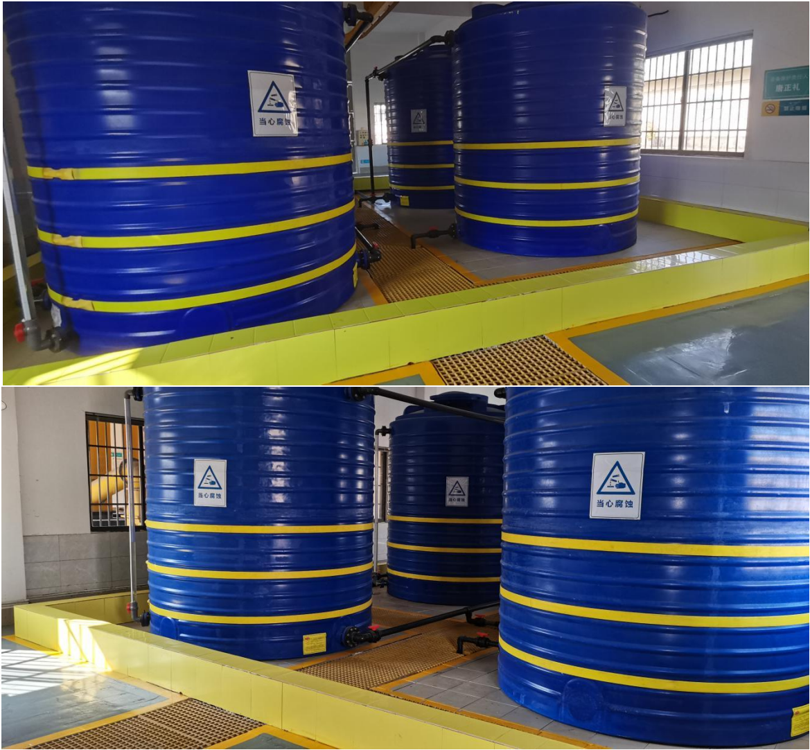
图 3-1 次氯酸钠储罐和围堰、导流沟
